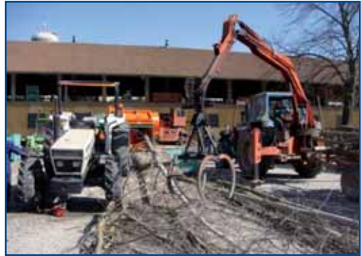
Fig. 8 - Cantiere di lavoro della pezzatrice di piante intere, alimentata da pinza meccanica
